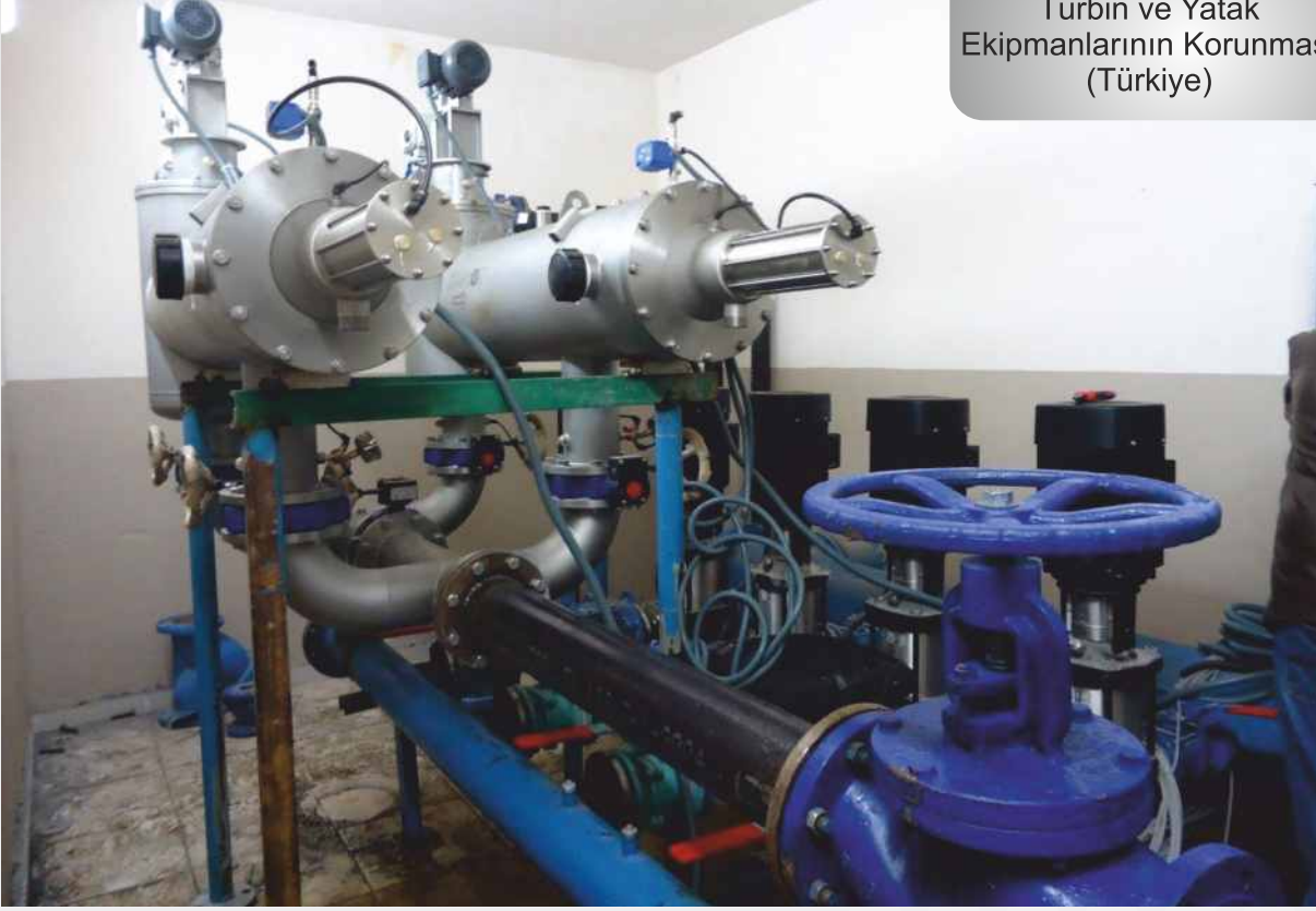
Türbin ve Yatak Ekipmanlarının Korunması (Türkiye)
