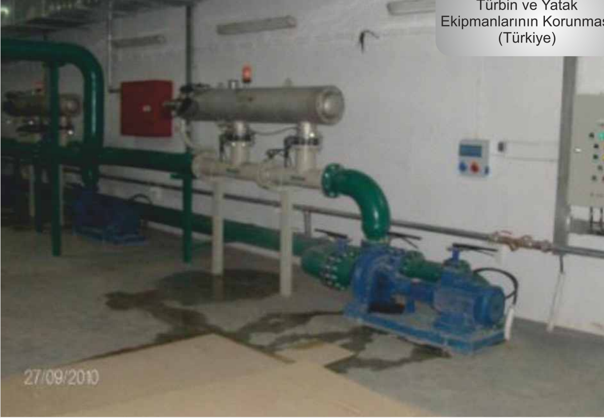
Türbin ve Yatak Ekipmanlarının Korunması (Türkiye)
