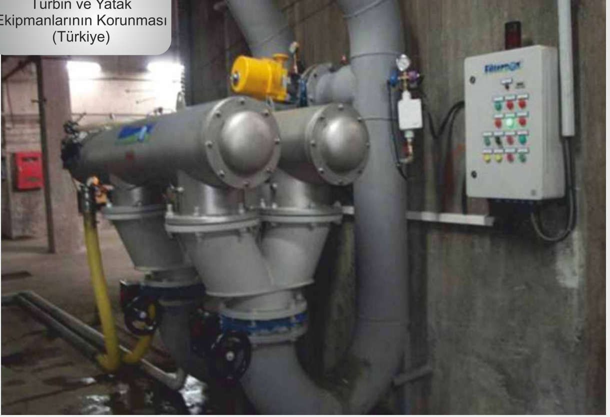
Türbin ve Yatak Ekipmanlarının Korunması (Türkiye)
