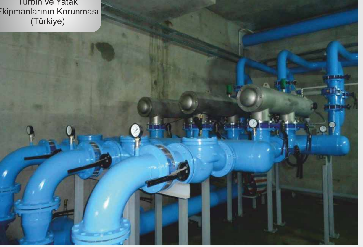
Türbin ve Yatak Ekipmanlarının Korunması (Türkiye)
